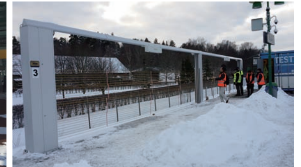
로프형 상하 개폐식 스크린도어(스웨덴 시범설치)
