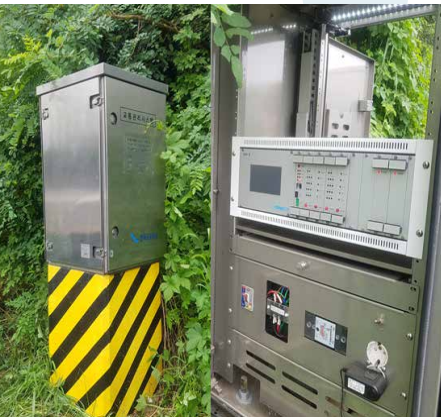
■ 일체형 센서 원격 모니터링 장비 설치
