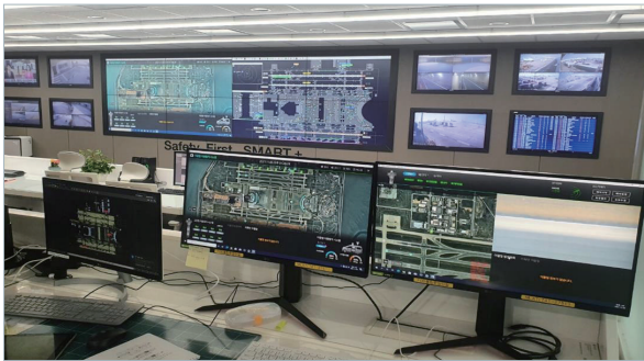
이동지역안전관리소에 설치되어 운영중인 이물질 자동 탐지 시스템의 통합운영콘솔
