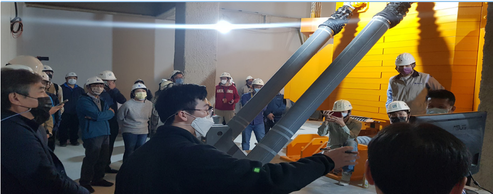
FUBON 생명(대만 타이페이)56층에 설치한 500ton 진자형 TMD의 현장시험 검수전경
