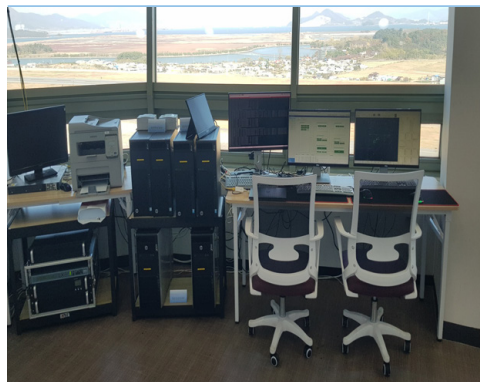
2023년 여수공항 주관제탑 13층 장비실에 설치된 옥내 장비
