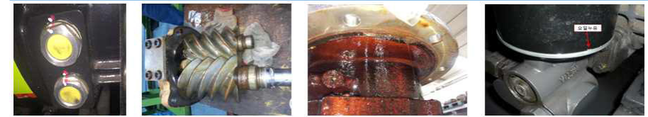
〈오일변색 (유제화)〉 〈수분에 의한 내부 발청〉 〈수분에 의한 내부 슬러지 발생〉 〈공기압축기누유〉
