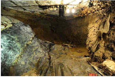
(a) 터널 내 변형으로 인한 지중구조물 손상
